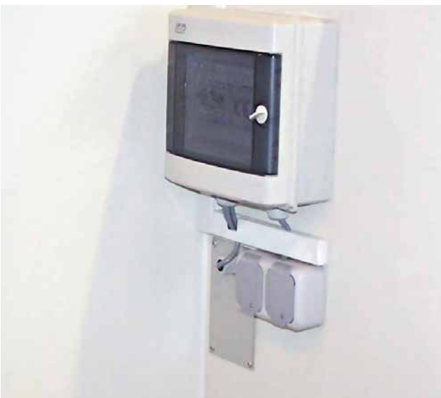
Verteilerkasten mit FI und Sicherungen
