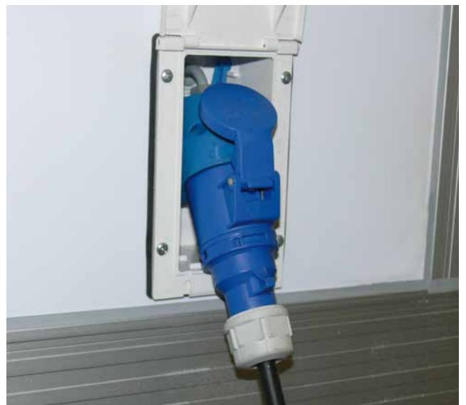
Einspeisesteckdose CEE 230 V / 16 A außen
